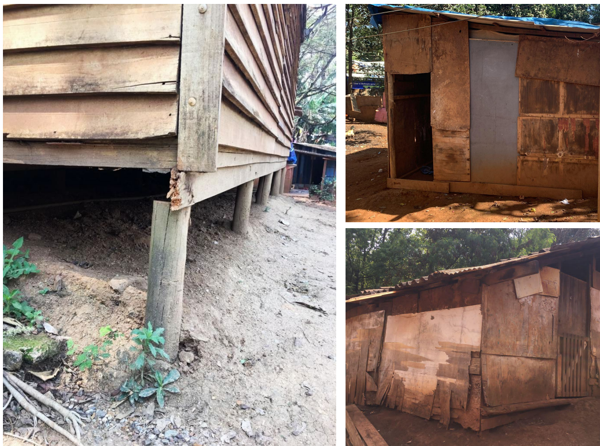
Figura 23, 24 e 25 - Fotos das condições mais comuns de risco estrutural. Da esquerda para a direita: condição de viga de piso e pilar quase vertendo, condição de fechamentos com madeirite e sobreposição de materiais de vedação precários.
