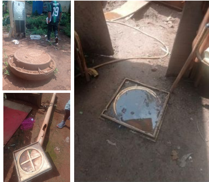
Figura 29, 30 e 31 - Fotos de exemplo das estruturas de esgotamento da SABESP, SESAI e improvisadas pelos moradores. Da esquerda para a direita, de cima pra baixo: Postos de visita (PVs) SABESP localizados dentro da aldeia Pyau, tubulações de esgoto avariadas; e caixa de passagem com entupimento.
